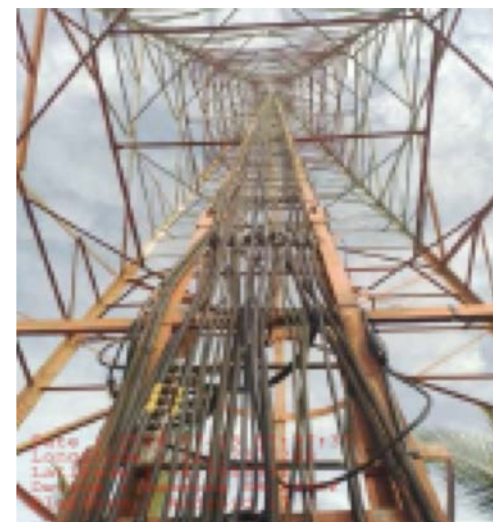
PENGECEKAN TRAY KABEL & TANGGA
