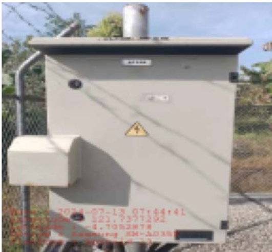
BOX ACPDB TERTUTUP
