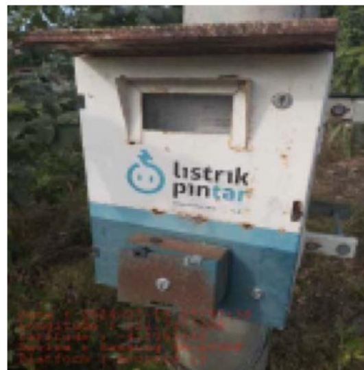
PENGECEKAN BOX KWH & KUNCI
